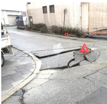
七尾市：道路の液状化
